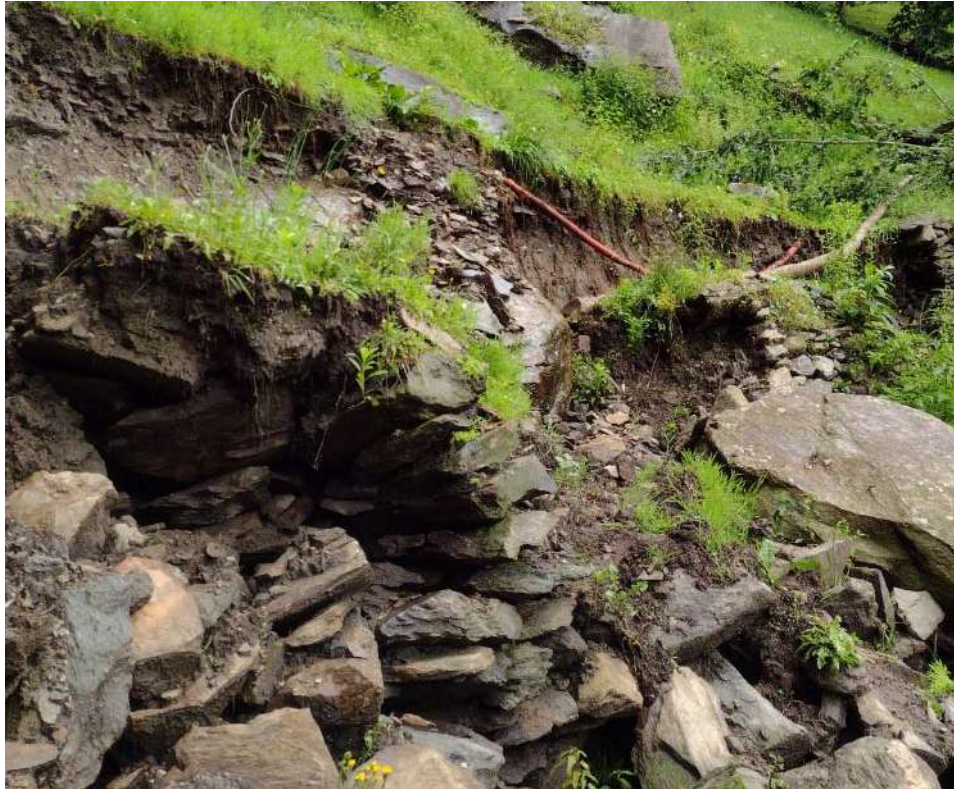
Foto 3: particolare del muro di monte crollato - secondo tratto.
