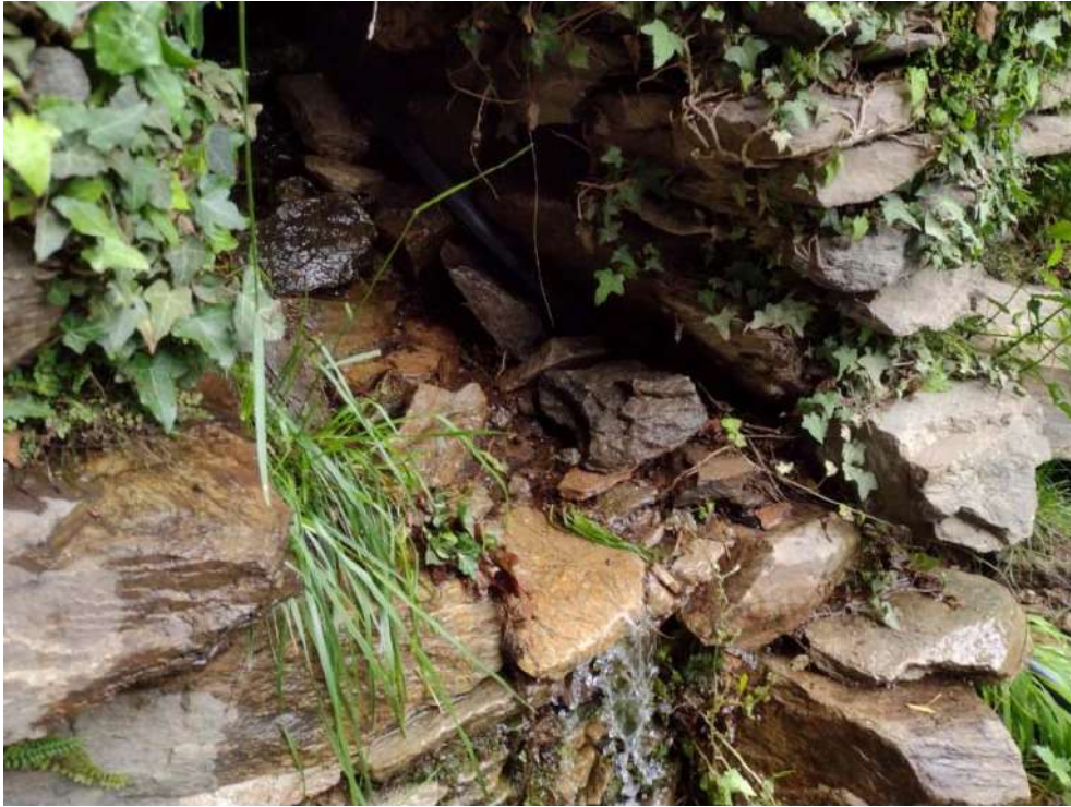
Foto 5: particolare del canale in uscita dal muro – tratto da sigillare (vi sono infiltrazioni nella parete sinistra con conseguente ruscellamento lungo il pendio e aumento della saturazione nel terreno di valle).
