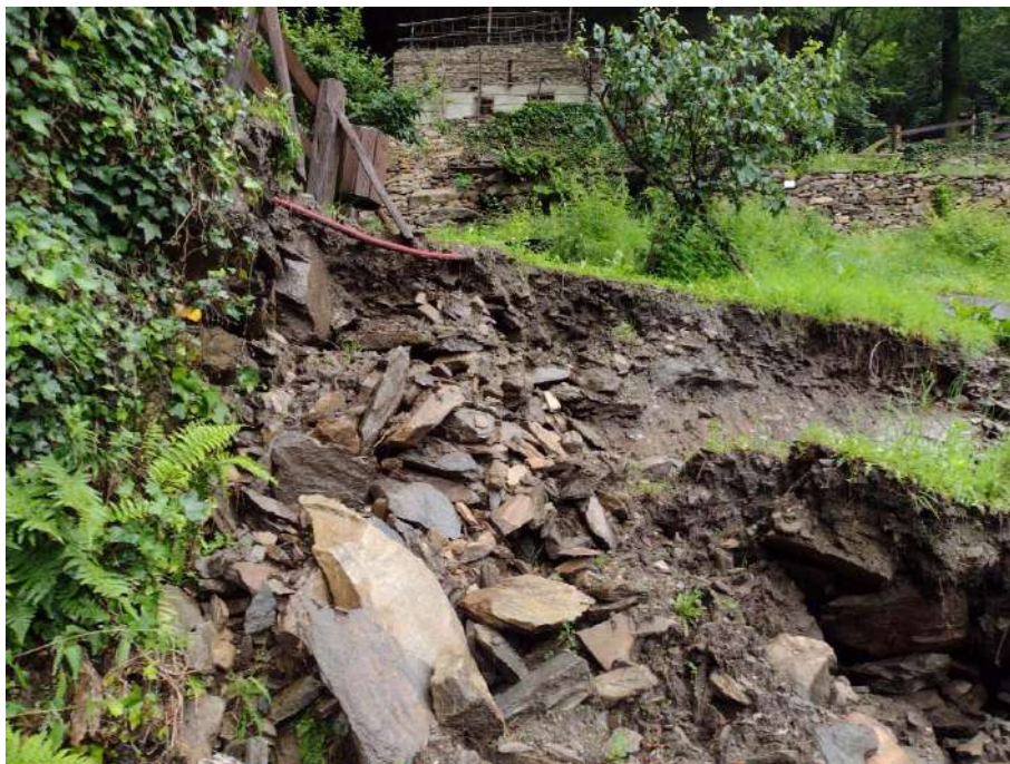
Foto 2: particolare del muro di monte crollato - primo tratto (primi 6 m).
