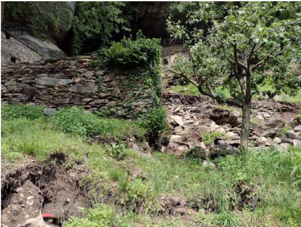
Foto 4: particolare del canale in pietrame nel tratto di valle danneggiato.
